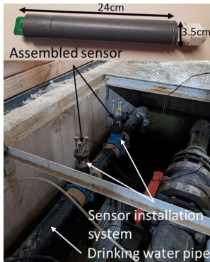
Figure – Deux capteurs installés dans une conduite d'eau potable et connectés via un câble USB à des ordinateurs de contrôle.
